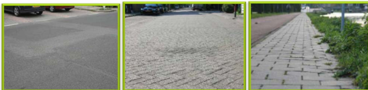
Foto 4-6 Kwaliteitsniveau Basis (B): functioneel, reparaties en lichte schade zichtbaar
