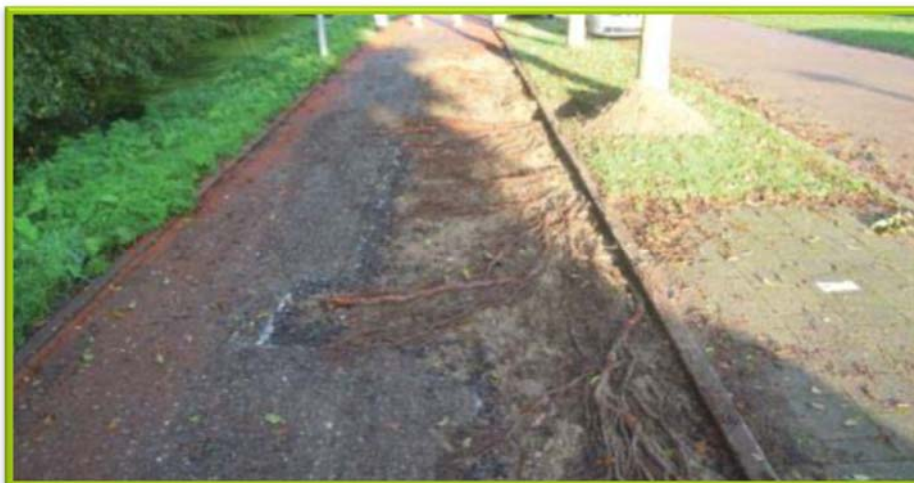
Figuur 4c: Wortels reiken tot ver onder het fietspad
